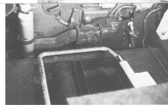
Der Blick auf den Brandschott zeigt Einzelheiten der automatischen Feuerlöschanlage. Rechts oben sitzt die Sum-Einspritzpumpe für die Kraftstoffanlage.
